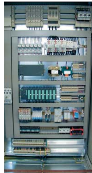
Paneles de distribución
