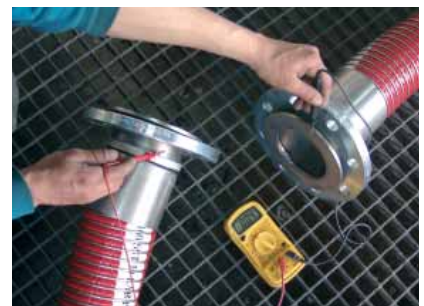
Conductividad eléctrica. Electrical continuity.
